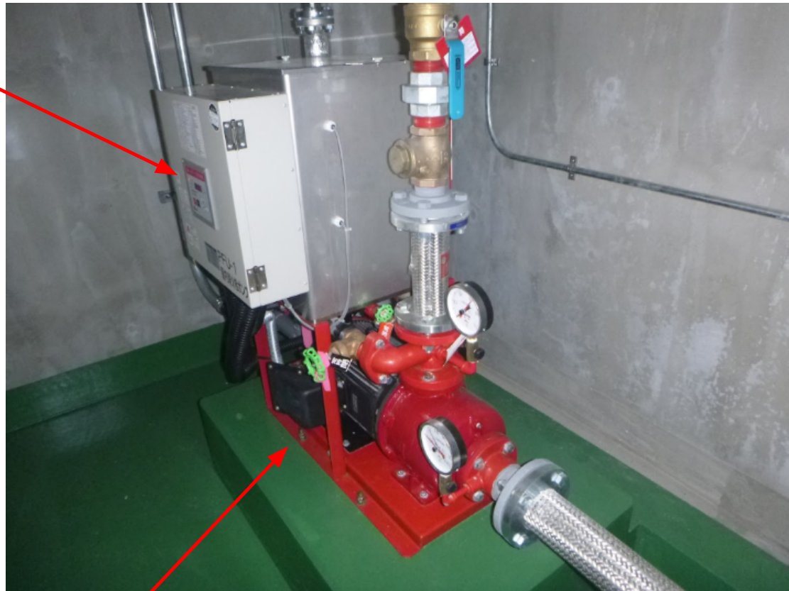
エバラ消火ポンプ制御盤 (EPM2-C25.5DX)
