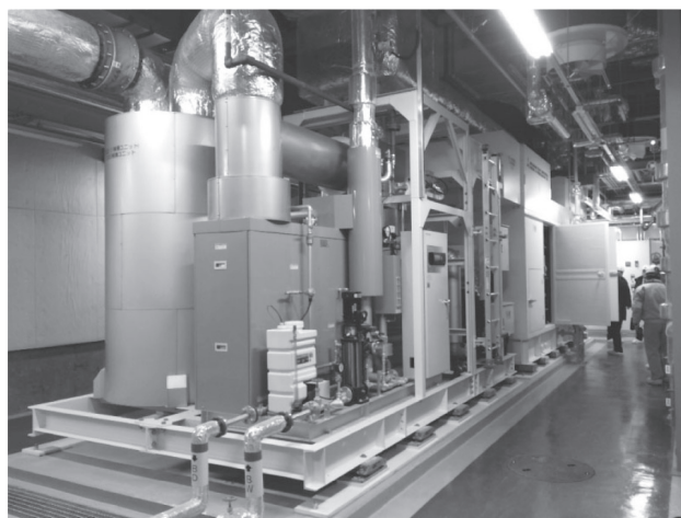
▲創世エネルギーセンターの天然ガスコージェネレーション
