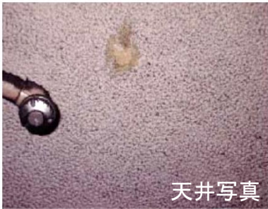
吹付けアスベスト (石綿吹付)
