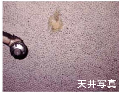
吹付けアスベスト (石綿吹付)
