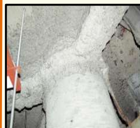
吹付けアスベスト
