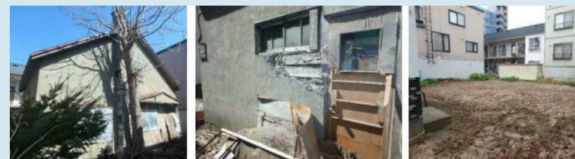
▲倒壊の危険性や景観を損なう特定空き家
