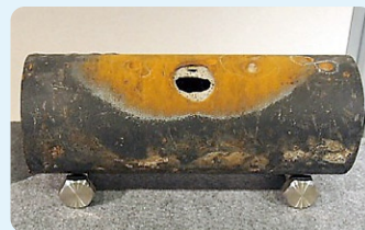
▲穴(約5cm)のあいた配水管
