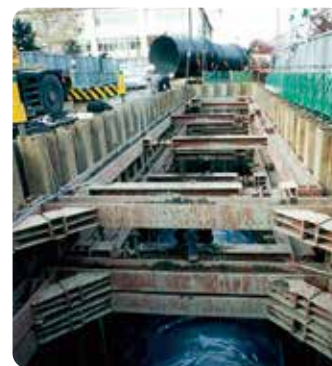
緊急貯水槽の設置 【昭和62(1987)年~】
