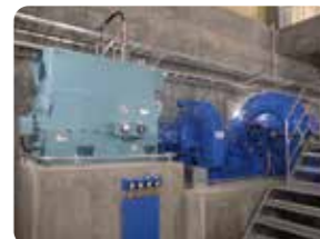
平岸配水池の水力発電設備
