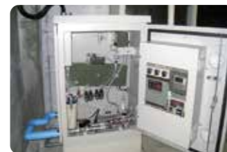
給水水質自動監視装置 (市内の公共施設)
