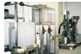
水源水質自動監視所内部 (上流のダムや橋)
