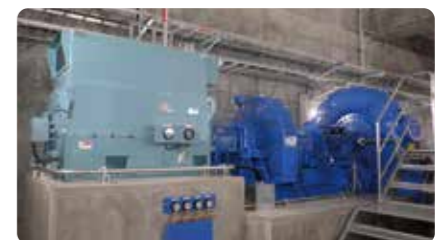
平岸配水池の水力発電設備
