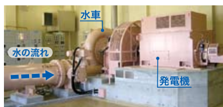
藻岩浄水場の水力発電設備と配水センターの太陽光発電設備
