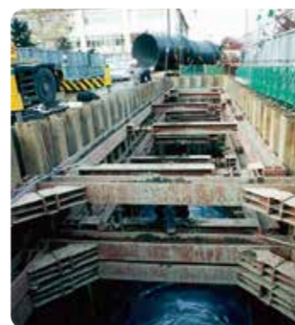
緊急貯水槽の設置 【昭和62(1987)年～】
