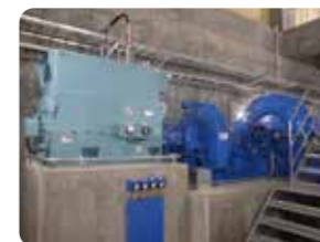
平岸配水池の水力発電設備
