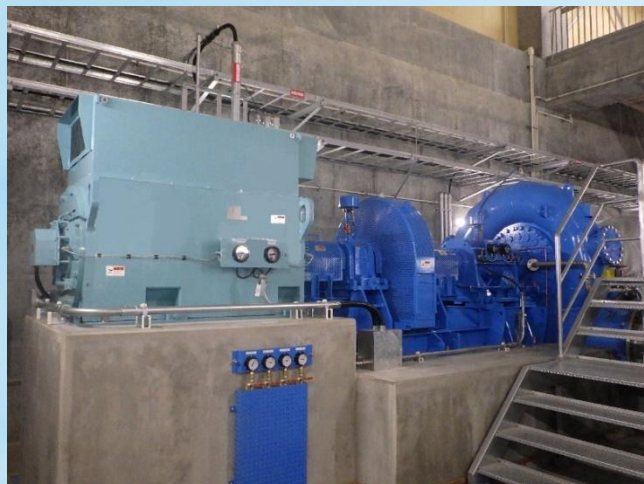
平岸配水池の水力発電設備
