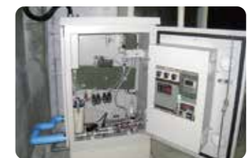
給水水質自動監視装置 (市内の公共施設)
