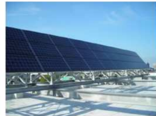
配水センター太陽光発電設備
