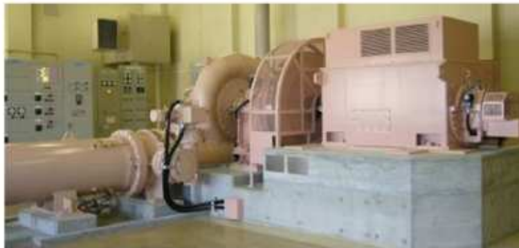
藻岩浄水場水力発電設備
