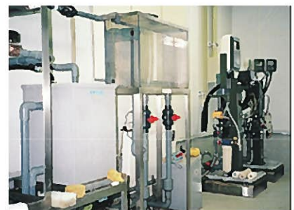
水質自動監視装置
