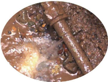
給水管からの漏水
