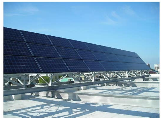
配水センターの太陽光発電設備
