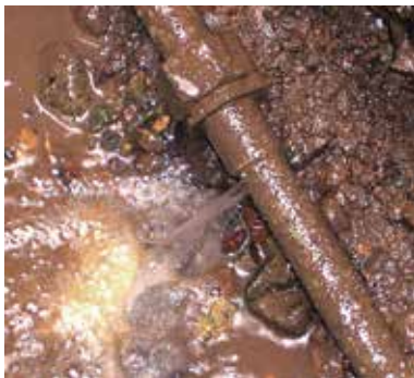
給水管からの漏水
