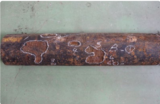
腐食が進んだ配水管（約50年経過）
