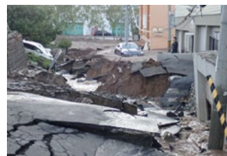
液状化による陥没
