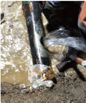
配水管からの漏水
