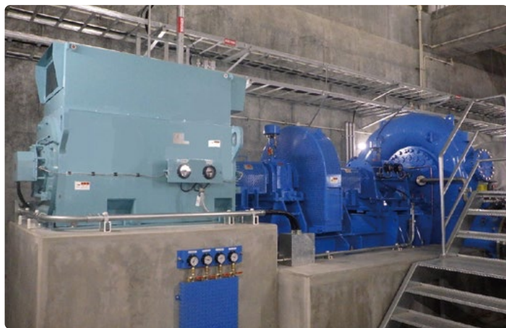
平岸配水池の水力発電設備
