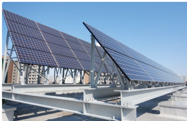
豊平庁舎の太陽光発電設備
