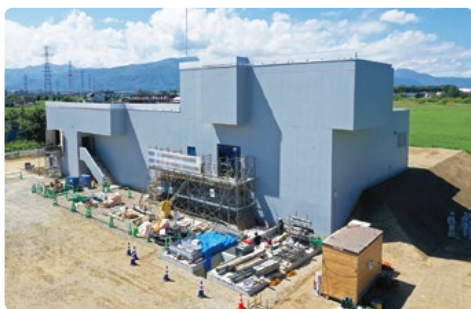
札幌ポンプ場 (石狩西部広域水道企業団が建設したポンプ場)
