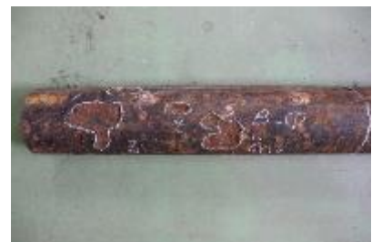
腐食が進んだ配水管（約 50 年経過）
