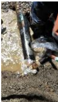
配水管からの漏水
