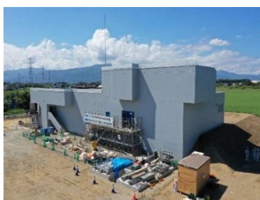
札幌ポンプ場 (石狩西部広域水道 企業団が建設したポンプ場)
