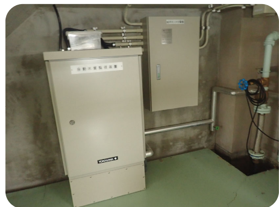
給水水質自動監視装置
