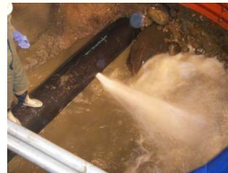
水道管の破損
