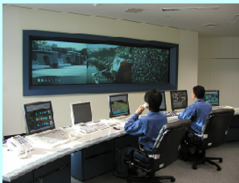
処理状況の監視（浄水場管理室）
