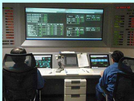
定量送水作業 （配水センター管理室での監視）
