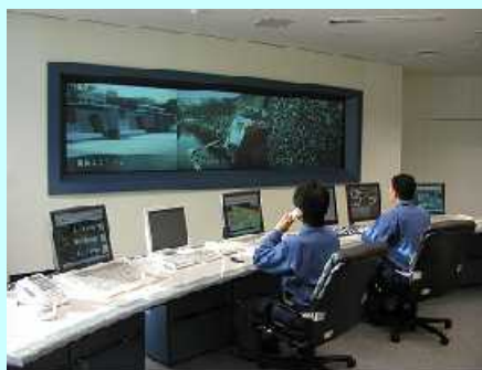
処理状況の監視（浄水場管理室）
