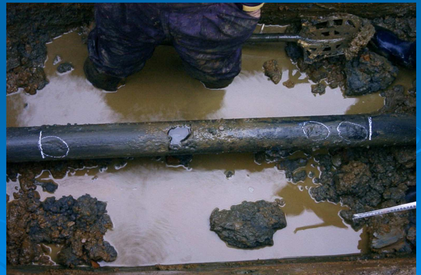
漏水事故発生状況(北区、31年間使用の管路)
