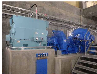
【平岸配水池の水力発電設備】
