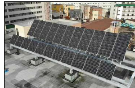
【豊平庁舎の太陽光発電設備】
