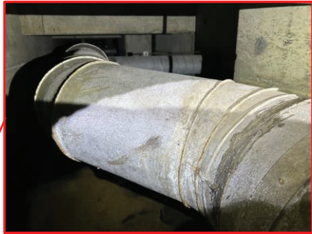
集塵ダクト (ピット線内)
