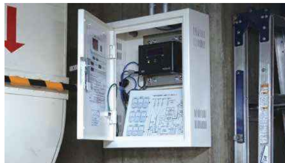
地震計の写真
