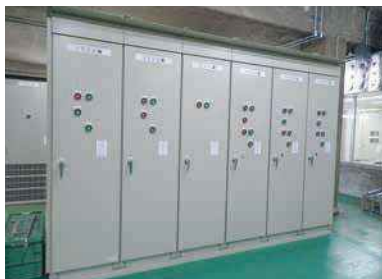
大谷地変電所ガス絶縁開閉装置
