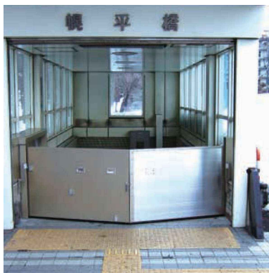
南北線 幌平橋駅 止水板
