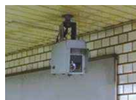
駅構内監視カメラ
