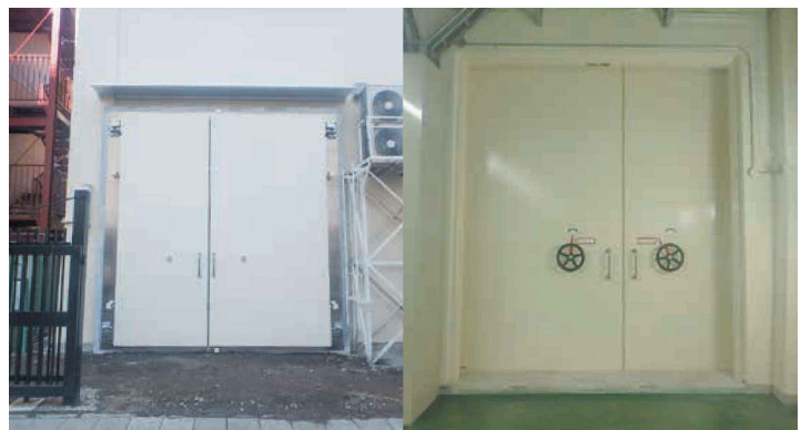
中の島変電所 止水扉
