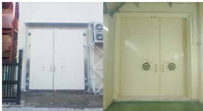
中の島変電所 止水扉
