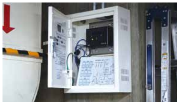
地震計の写真
