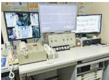
福住駅連動制御盤
