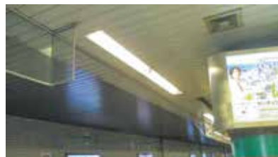
落下後の防煙垂壁
