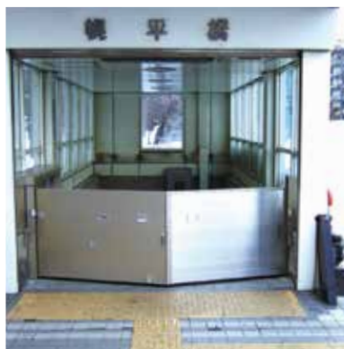
南北線 幌平橋駅 止水板
