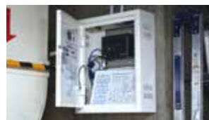
地震計の写真
