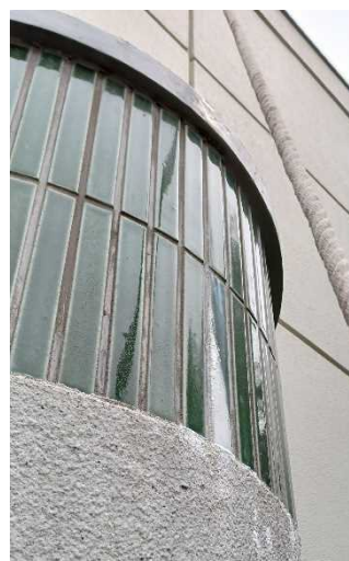
(タイルの状況)
