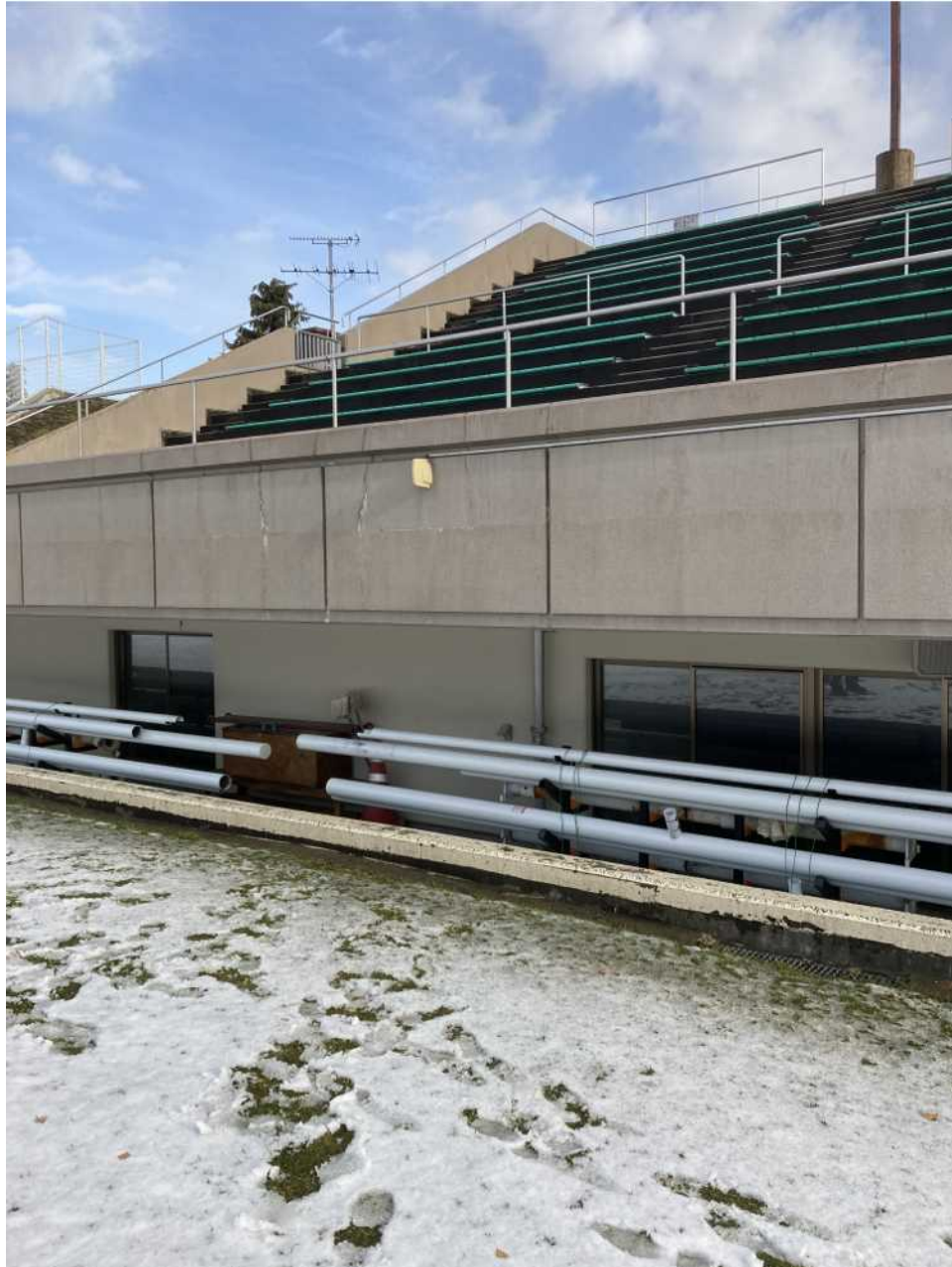
既設音響設備 写真2
