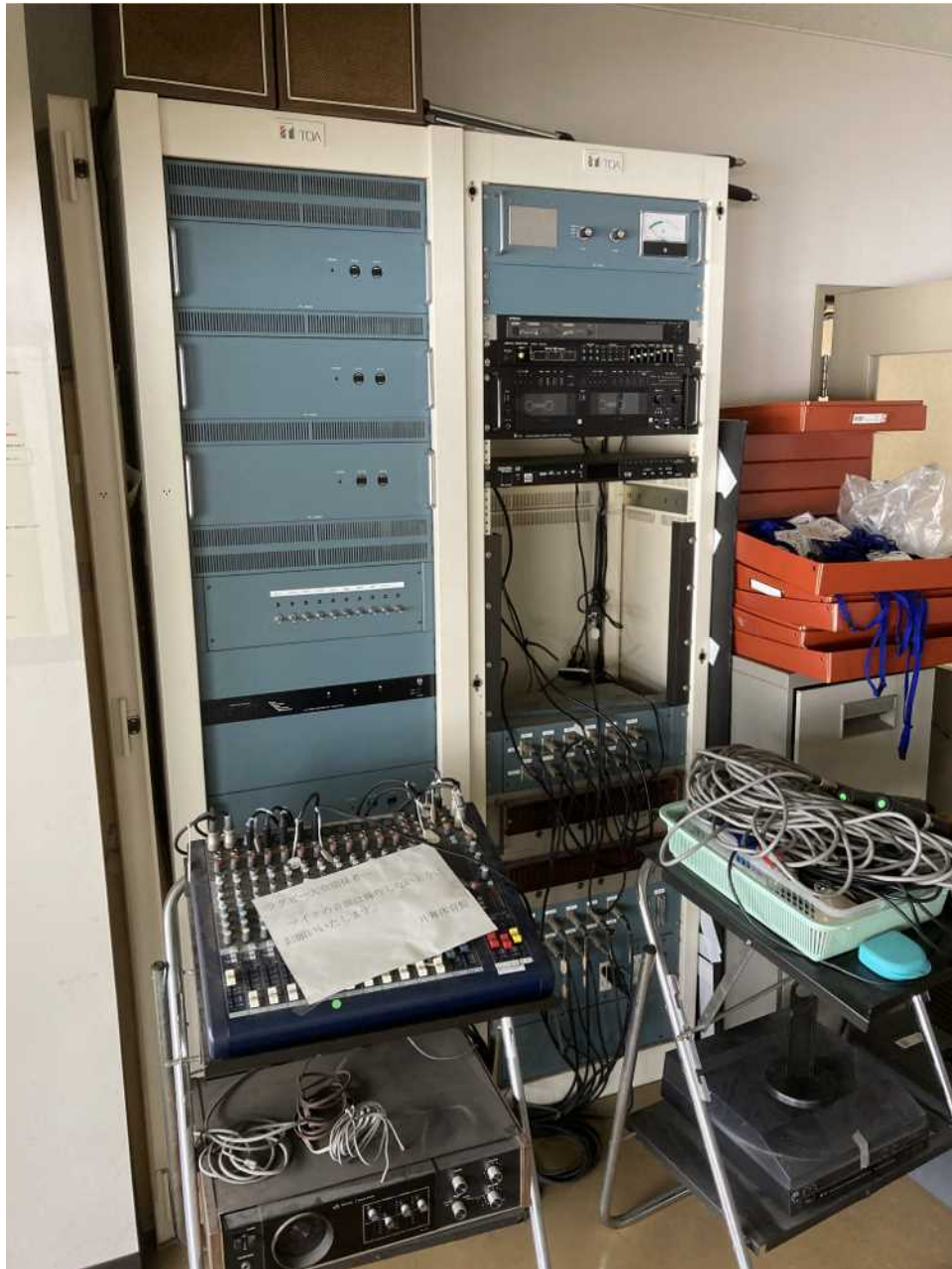
既設音響設備 写真1
