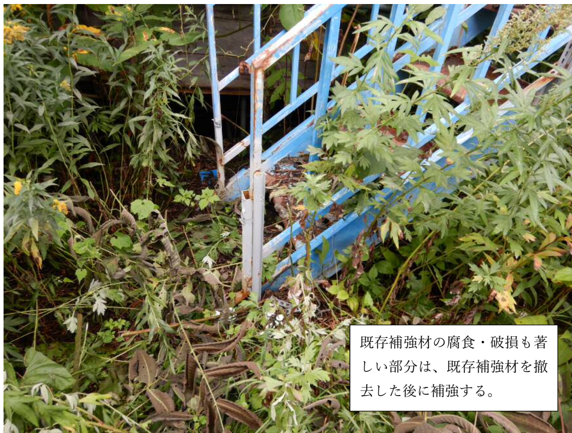
腐食・破損状況（横断橋①）
