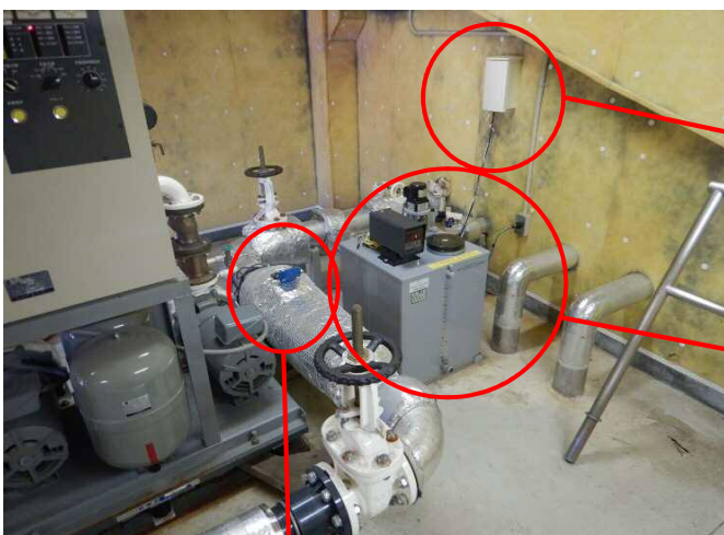
厚別公園競技場 バックスタンドポンプ室:電子式水道メーター100φ
