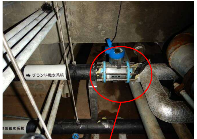
円山球場 機械室:電磁式水道メーター75φ (検出部)
