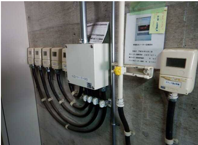
円山球場 機械室:メーター指示部
