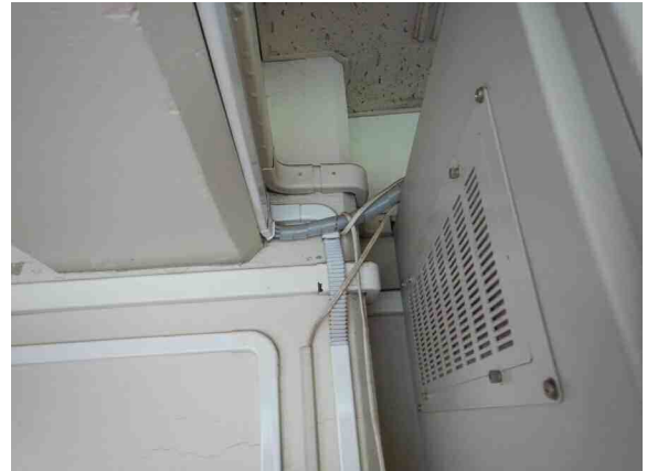
左写真の設備の裏側
