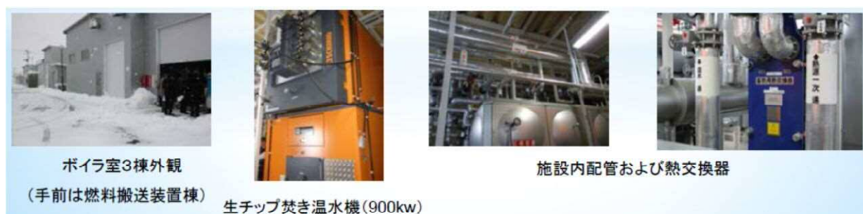
図7-4-2 木質バイオマスボイラー概観
