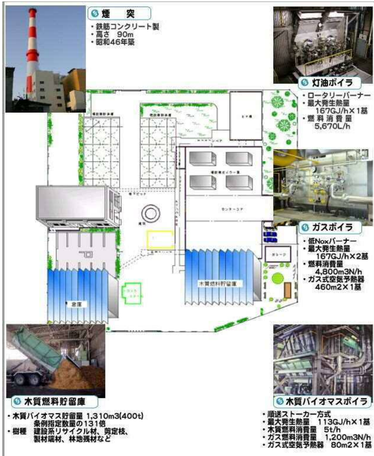
図 7 - 1 - 2 中央エネルギーセンターの熱供給設備
