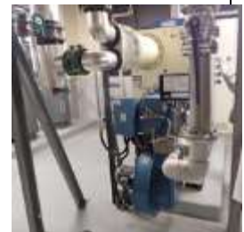
ガスボイラー
