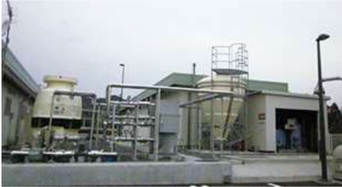
ペレットボイラー(新東名 藤枝岡部 IC 料金所)
