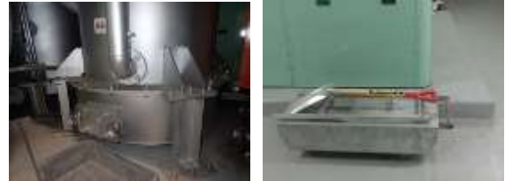
ボイラー本体 掃除用灰箱とスコップ
