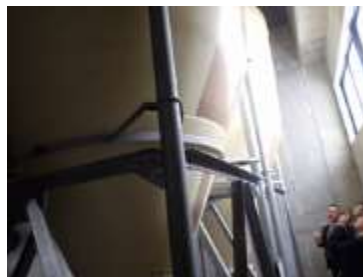
ペレットサイロ（2 基）
