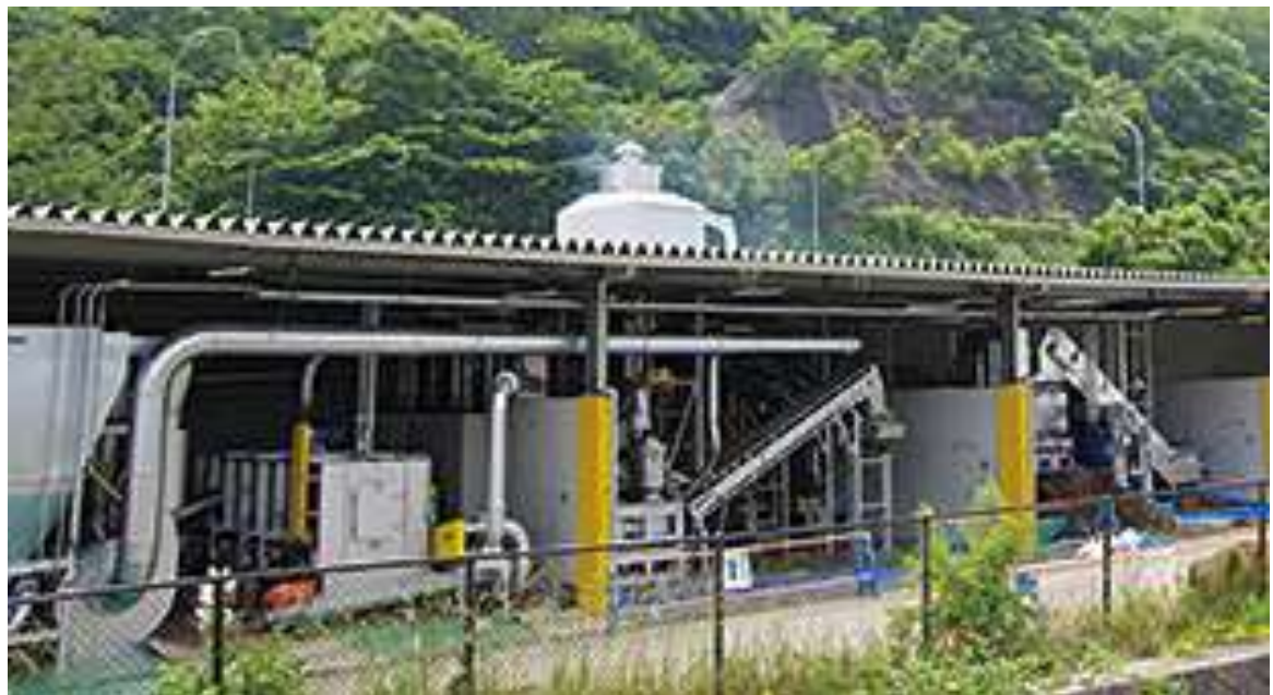
ペレット製造設備(東名 旧鮎沢 PA)
