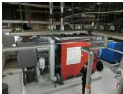
ボイラー室の様子
