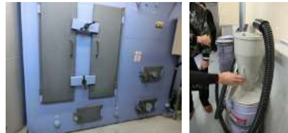
ボイラー燃焼室の側面扉 灰専用掃除機
