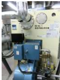
ガスボイラー
