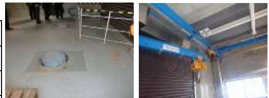
ペレット投入口 ペレット置き場クレーン
