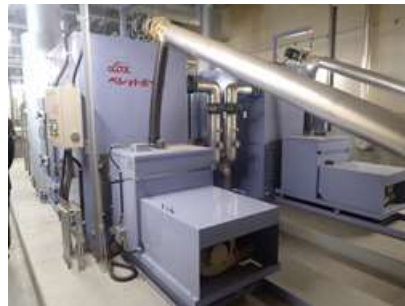
ペレットボイラー（2 基）
