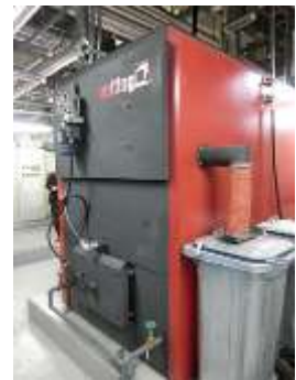
ペレットボイラー
