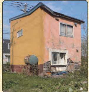
▲長年放置され、損傷した家屋
