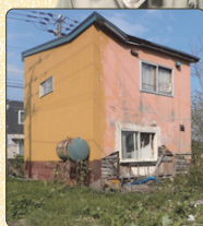
▲長年放置され、損傷した家屋
