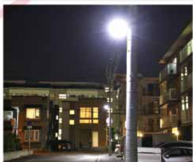
街路灯の設置・管理
