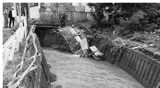
▲大雨翌日（9月12日）の望月寒川の様子。 一部で、川があふれるなどの被害がありました。
