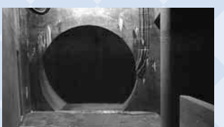
※11月下旬～3月中旬は、融雪に使う処理水が入っているため貯留管は見えません
