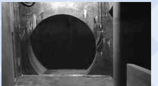
※11月下旬～3月中旬は、融雪に使う処理水が入っているため貯留管は見えません
