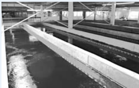
▲薬品を入れてゆっくりと水をかき混ぜ、水の濁りなどを取っていきます
