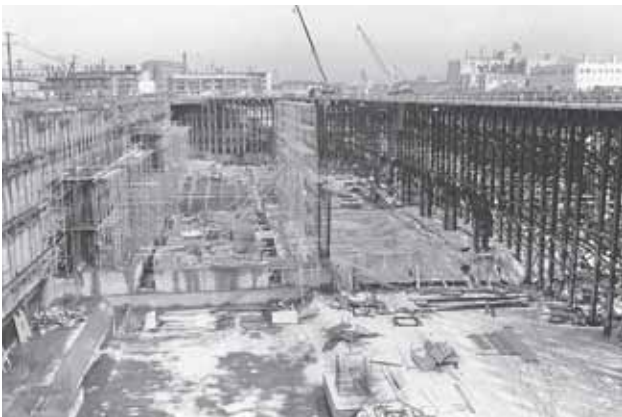
▲昭和48年、地下鉄東西線の建設工事。昭和51年6月に、琴似～白石間が開通した。
