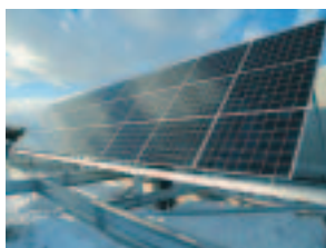
▲3m×13mの巨大な太陽光パネル
