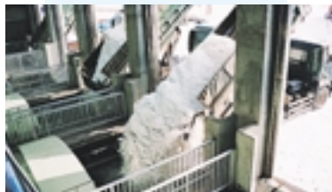
厚別処理場にある融雪槽（厚別区）
