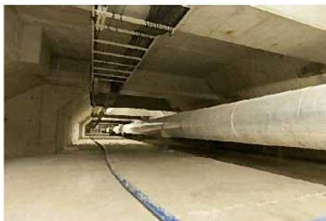
チ・カ・ホ地下ピット内の熱導管
